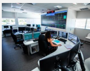
Bureau de Conduite Centralisée de l'électricité calédonienne
